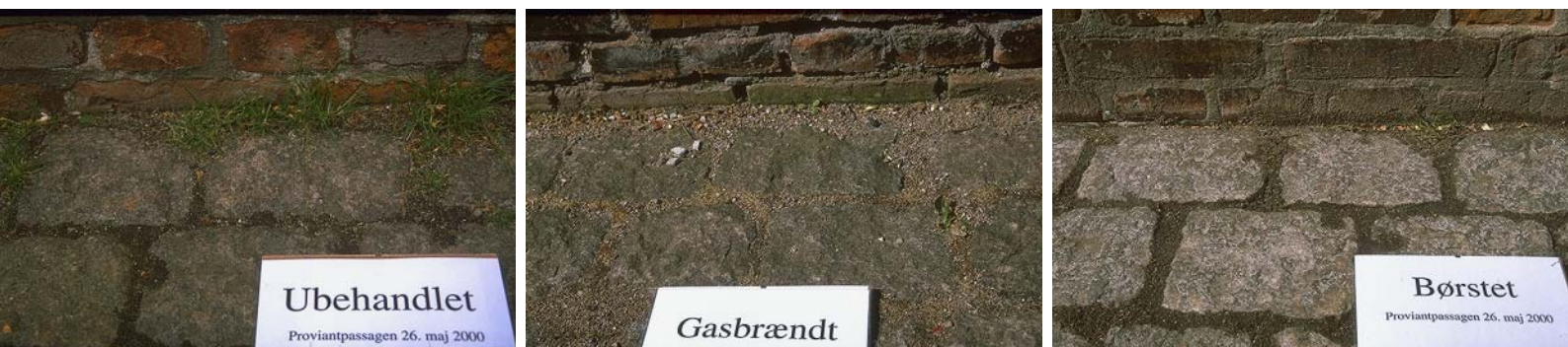
Figur 12. Til venstre ses ubehandlet parcel langs muren til bibliotekshaven. I midten en flammebehandlet parcel uden ukrudt. Til højre en børstet parcel. Børstningen ændrer på overfladen af belægningen. Fotos fra d. 26. maj.
