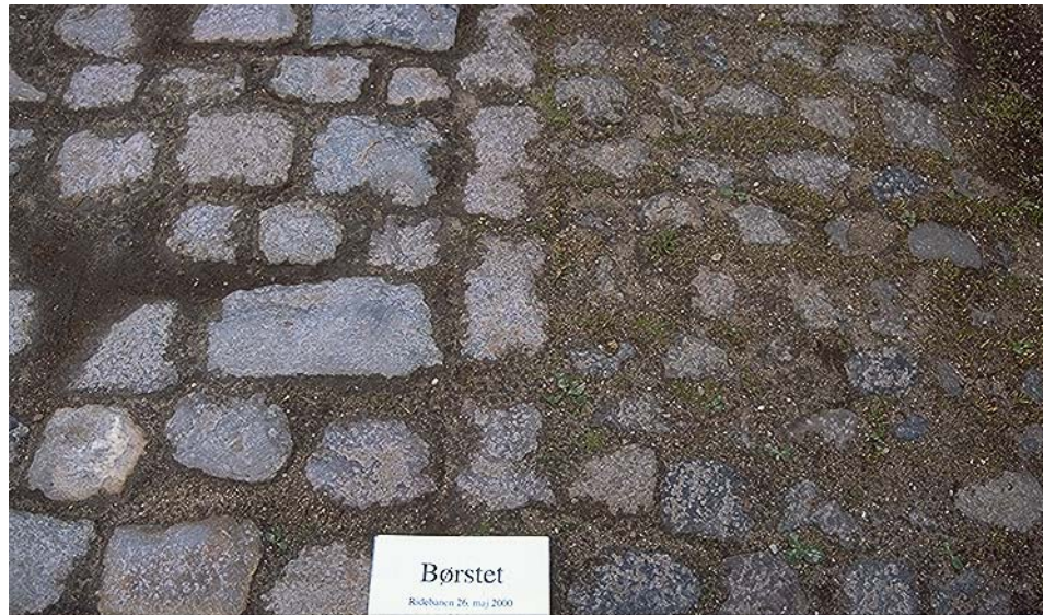
Figur 18. Belægningen til venstre i billedet er børstet, 5 dage før billedet er taget. Her fremstår de enkelte sten i belægningen renfejete, hvorimod den ubørstede del til højre ikke fremstår acceptabel. Foto fra Ridebaneanlægget den 26. maj.
